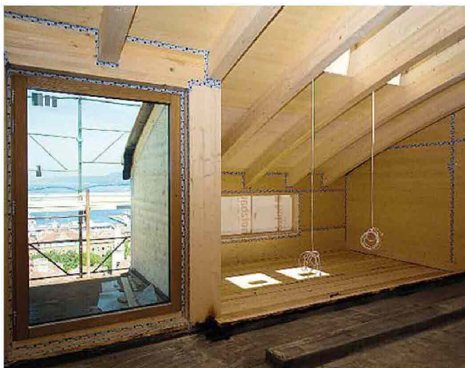
Un interno dell'edificio Panorama Giustinelli di Trieste
